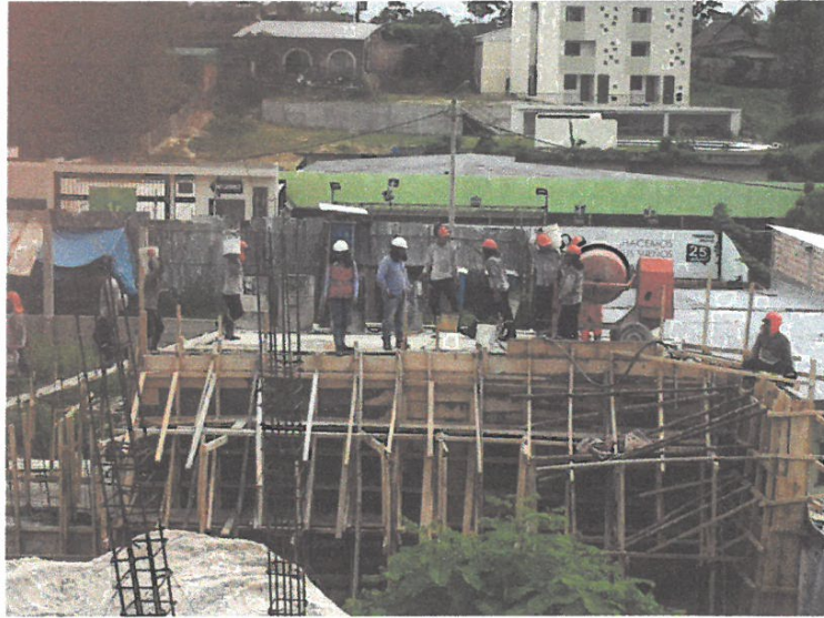
VACIADO DE LA PARTE SUPERIOS DEL MURO 5, ASISTENTE DEL SUPERVISOR EN CONSTANTE MONITOREO
